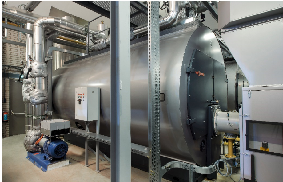
Bild 6 Fernwärmeerzeugung (Fabr. Viessmann)
